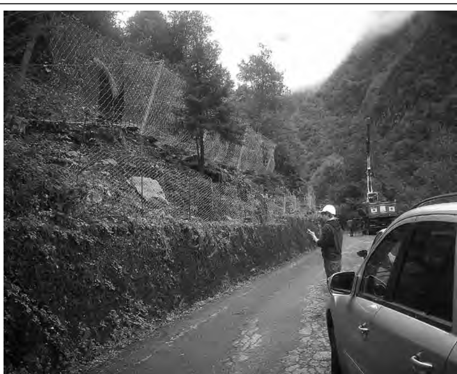
Paramassi realizzato sul tratto di strada Monno-Vedello.
